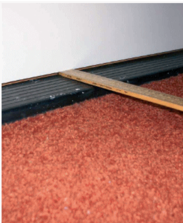
9. Overstroomvoorziening wordt beperkt door de stofdeur. (bron: Adviesburo Nieman B.V.)
