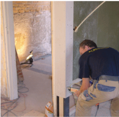
5. Brandwerend bekleden van een stalen kolom. (bron: Klusservice Uw Rechterhand & Partners B.V.)
