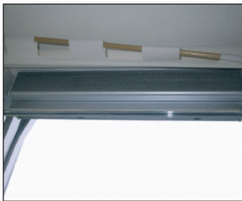
15. Ventilatiooster in het kozijn. (bron: Adviesburo Nieman B.V.)
